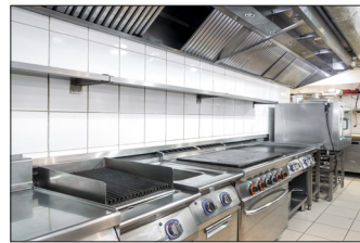
Mur soumis avec éclaboussures
